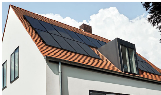
PV-Module für selbsterzeugten Strom
