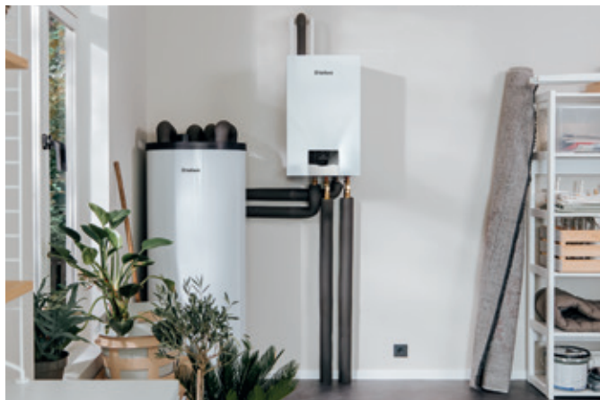
Hydraulikstation kombiniert mit einem 200 Liter Warmwasserspeicher
